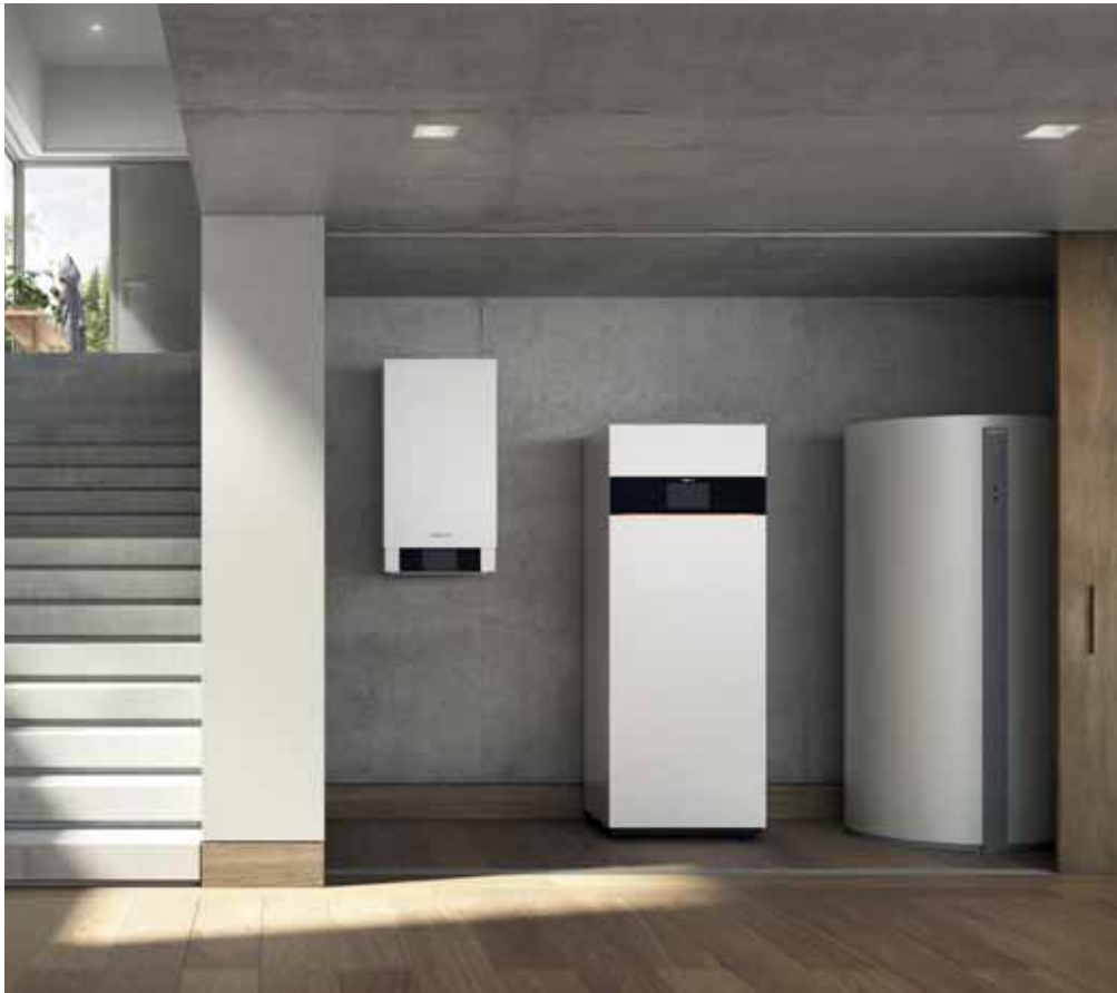
Brennstoffzelle Vitovalor PA2 nachgerüstet in einer Anlage mit Gas-Brennwert-Wandgerät Vitodens 200-W und Heizwasser-Pufferspeicher Vitocell
